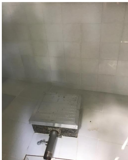
Caixa de Captação
